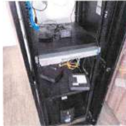
1.10 Rack de servidores
