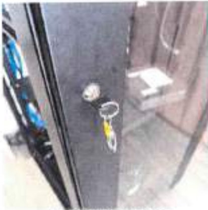
1.10 Rack de servidores
