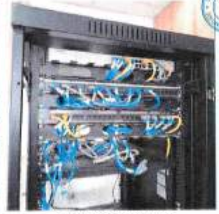
1.10 Rack de servidores
