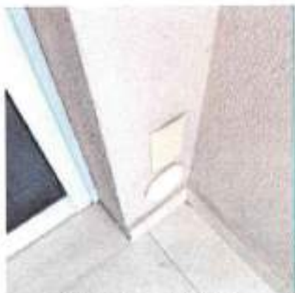
2.7 Tomadas e interruptores
