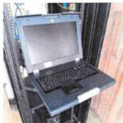
1.10 Rack de servidores
