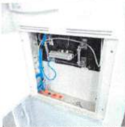
1.6 Quadro de disjuntores e distribuição
