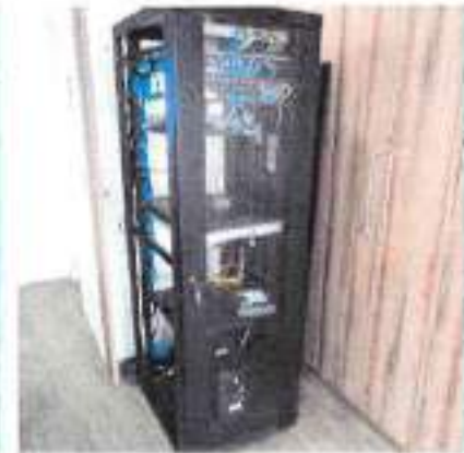
2, 10 Rack de servidores
