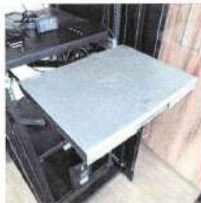
1.10 Rack de servidores
