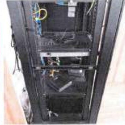
1.10 Rack de servidores
