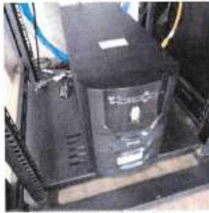
1.10 Rack de servidores
