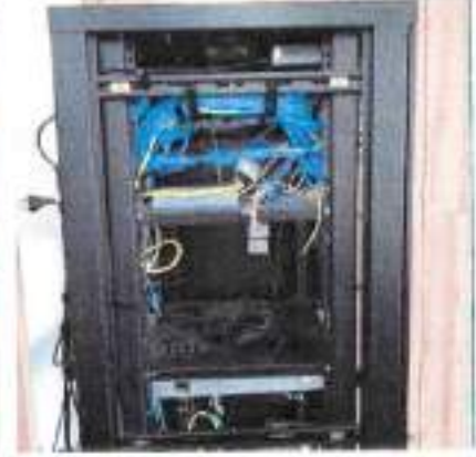
1.10 Rack de servidores
