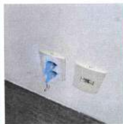
1.5 Tomadas e interruptores
